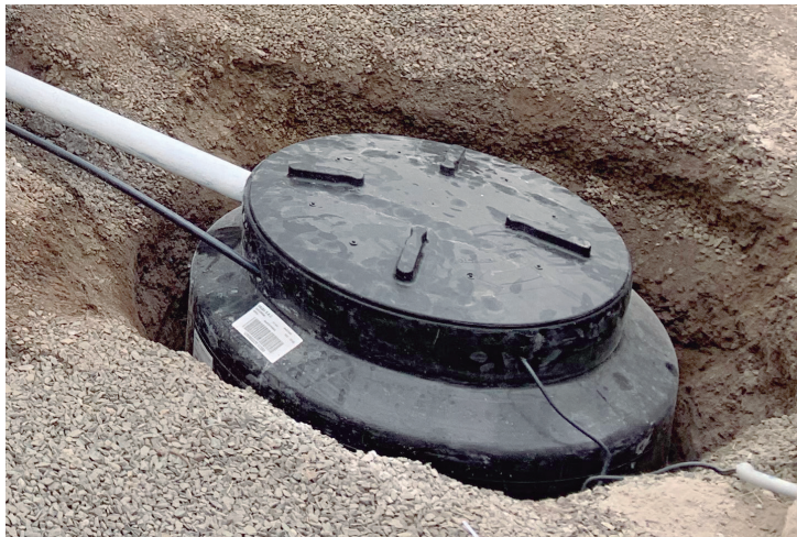
Figura 5. Tanque de agua
