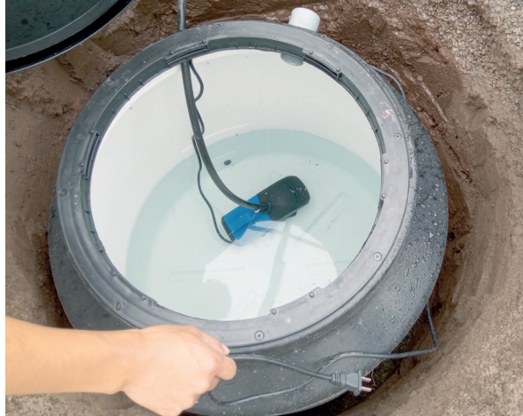
Figura 29. Revisión del nivel del agua respecto a la bomba
