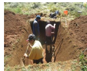
Figura 1. Las paredes del silo debe tener algo de inclinación (Talud). Foto: EEBI
