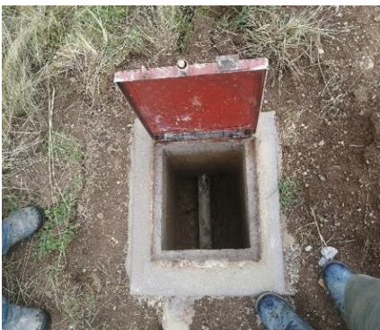
Llave para control de flujo de agua
