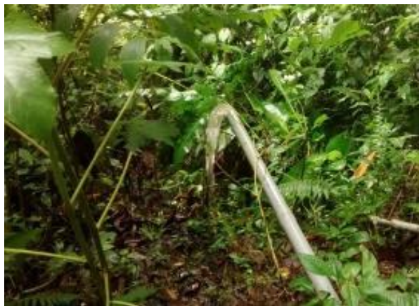
Sistema de conducción de agua
